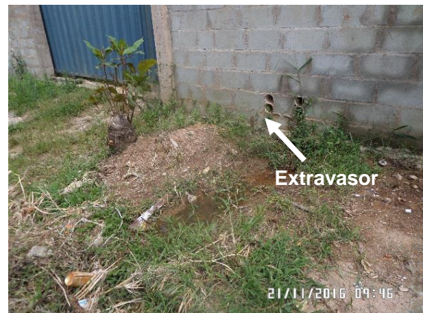
Figura 6.4 – Extravasor de água da propriedade particular para a rua
