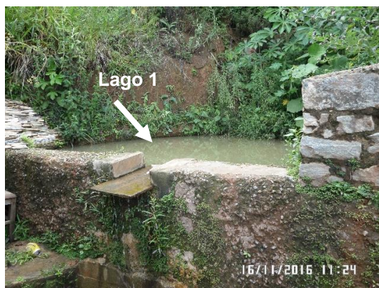
Figura 6.16 – Lago 1: Extravasamento de água
