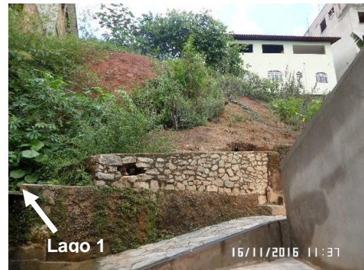
Figura 6.19 – Ocorrência de erosão à montante do Lago 1
