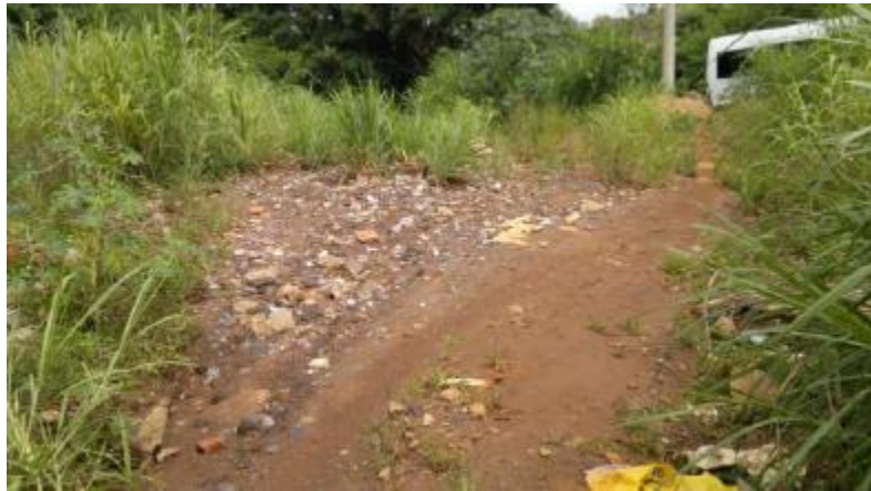
Figura 6.13 – Carreamento de sedimentos ocasionando assoreamento no local
